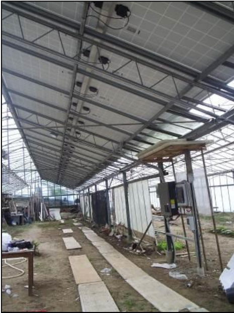
Arma di Taggia(IM) – 15 kW su serra
